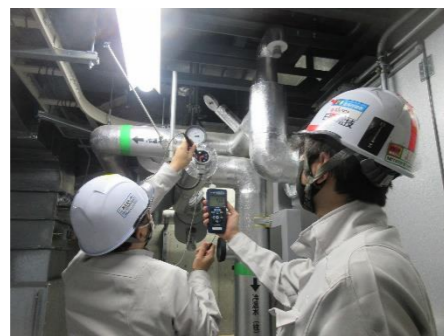
中央監視設備保守点検
