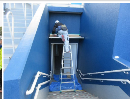
ショーコート雨漏り対策
