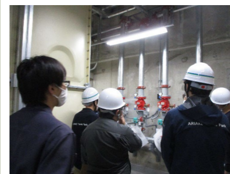
消防設備操作習熟訓練
