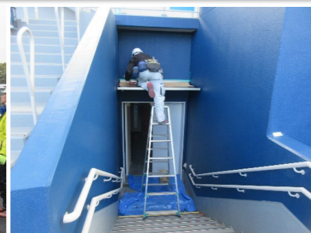
ショーコート雨漏り対策
