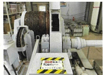
稼働部巻込注意の表示
