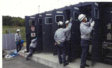
電気設備の法定点検(停電作業)
