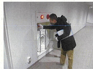
消防設備の点検
